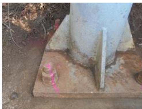
ベースプレートの腐食
