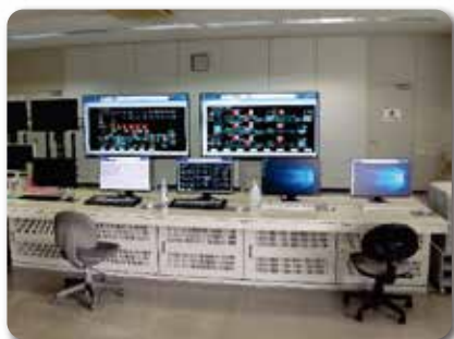
更新した中央監視制御設備
