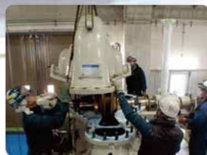
分解点検中のポンプ設備
