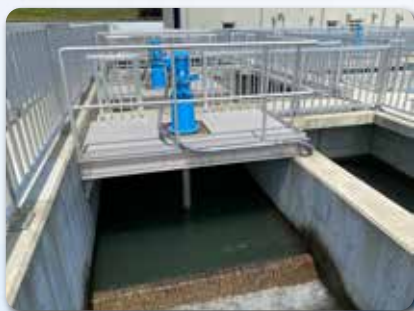
[急速かくはん池]
