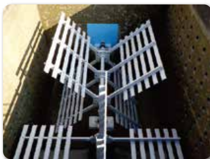
更新した浄水場の緩速攪拌機
