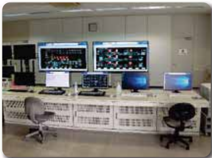
更新した中央監視制御設備
