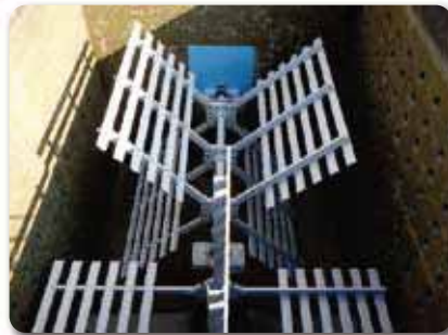
更新した浄水場の緩速攪拌機
