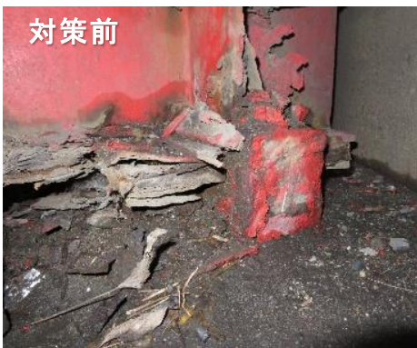
老朽化により桁・支承が腐食
