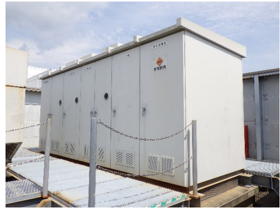
更新予定の北勢水道事務所受変電設備
