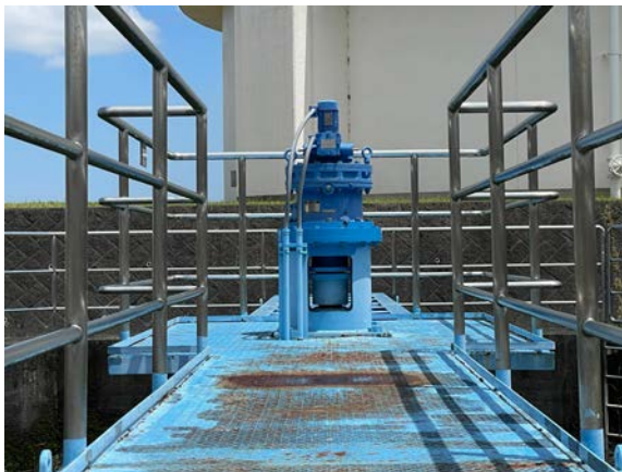
分解点検予定の多気浄水場機械設備 (排水池搔寄機)
