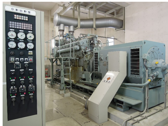
更新予定の多気浄水場非常用発電設備
