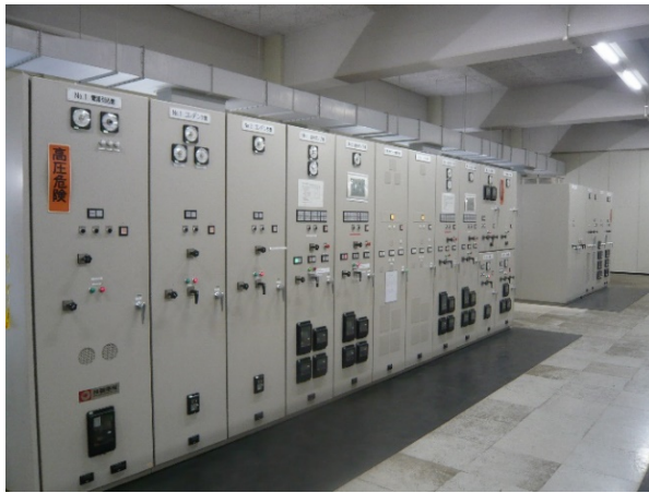
更新予定の多気浄水場送水ポンプ棟電気設備 (受電盤、制御盤等)
