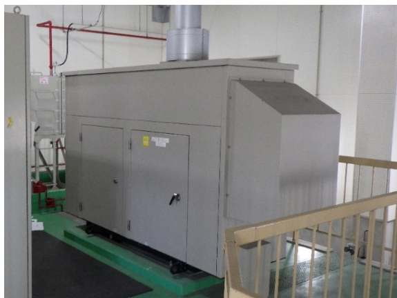
更新予定の桑名加圧ポンプ所非常用発電設備
