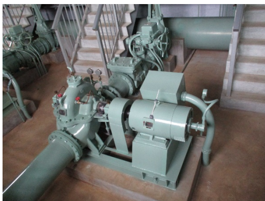
分解点検予定の新屋敷取水所ポンプ設備
