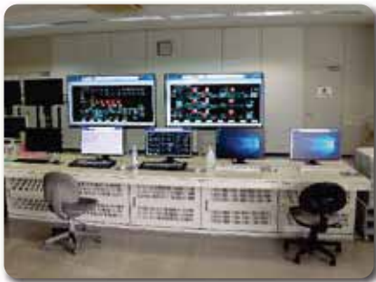
更新した中央監視制御設備
