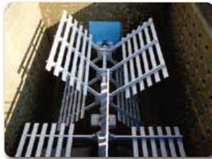
更新した浄水場の緩速攪拌機
