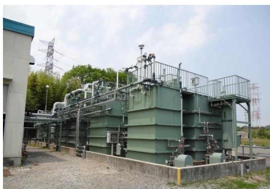
汚染地下水を浄化する水処理施設
