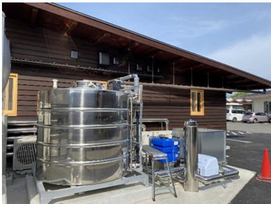
写真-7. 雨水利用施設
