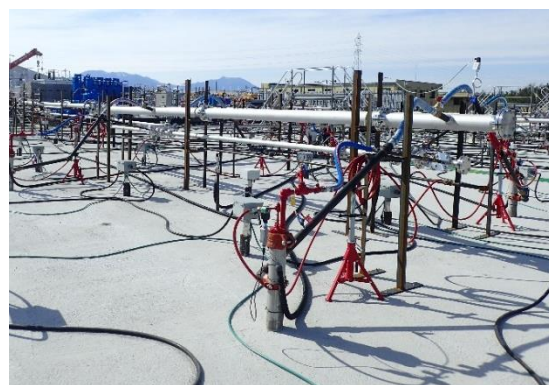
熱処理による浄化設備
