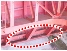
放流ゲートの発錆状況
