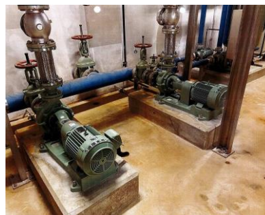
設備の整備、更新（ろ過原水ポンプ）
