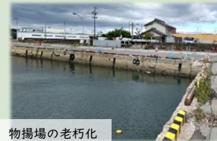
物揚場の老朽化
