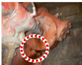
低水放流設備の漏油状況
