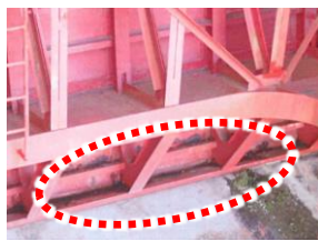
放流ゲートの発錆状況
