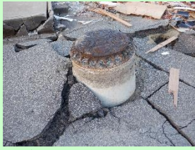
浮き上がったマンホール
