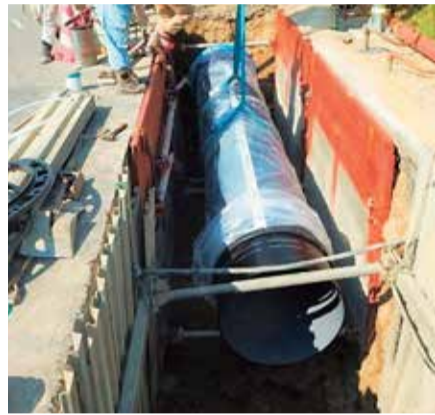
地震に強い水道管への更新
