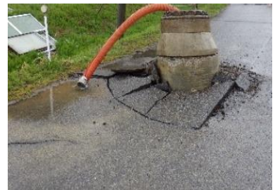
能登半島地震下水道施設被災状況
