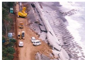
井田地区海岸平成9（1997）年被災状況
