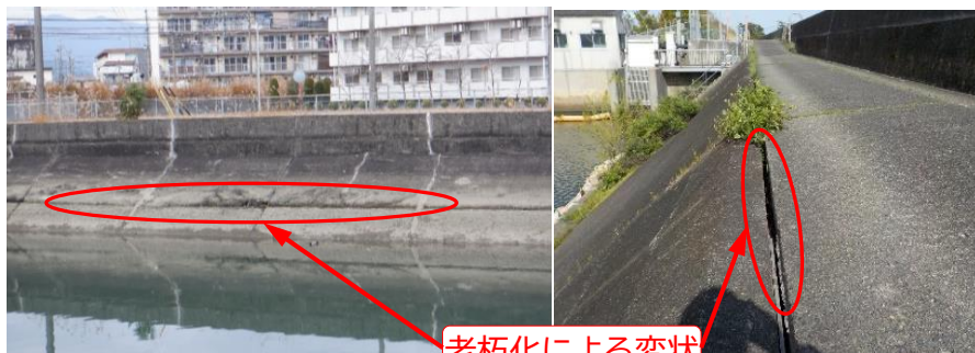
老朽化による変状
