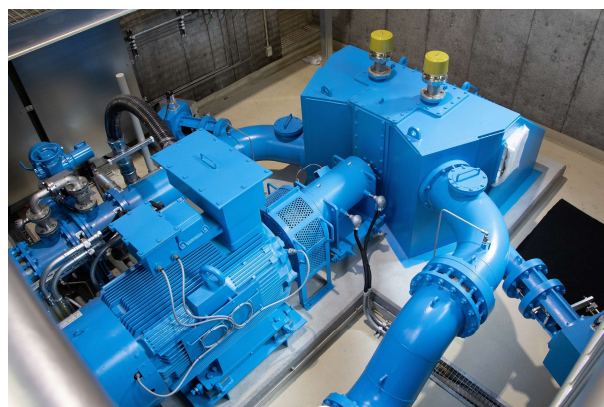
小水力発電所
