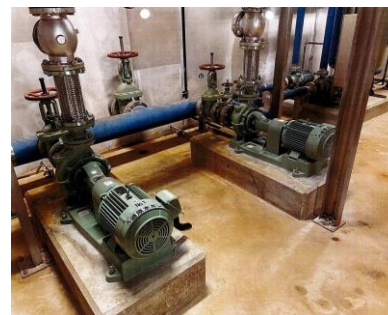
設備の整備、更新（ろ過原水ポンプ）
