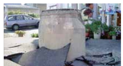
つ た 突き出したマンホール
