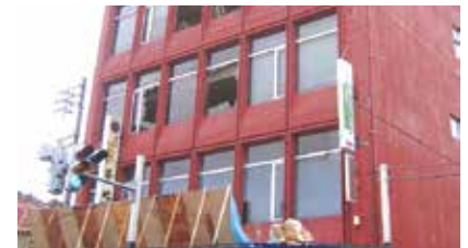
は さん らっ か まど 破損、落下した窓ガラス
