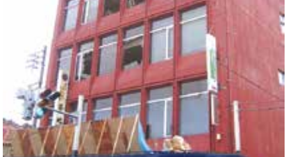
破损、掉落的窗户玻璃
