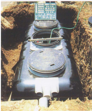
合併処理浄化槽
