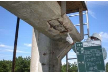
破損 (スライドゲート) 資料：三重県
