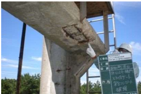
破損 (スライドゲート) 資料：三重県
