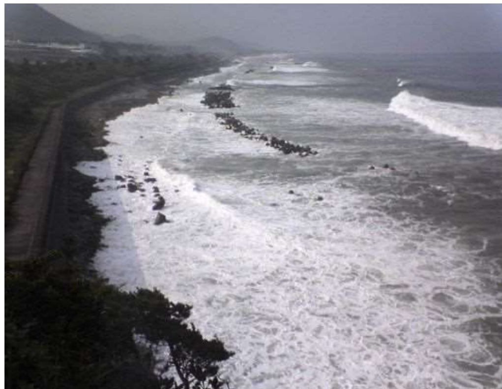
侵食後（平成 27 年 9 月撮影）
