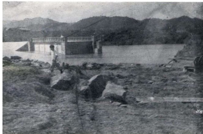
一般国道の流失（熊野市志原地内）
