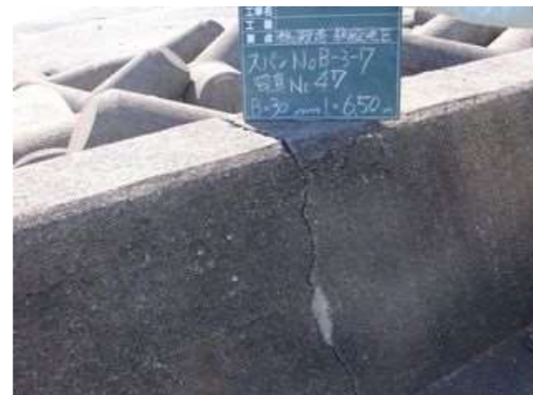
変状：ひび割れ(鶴殿港鶴殿地区)
