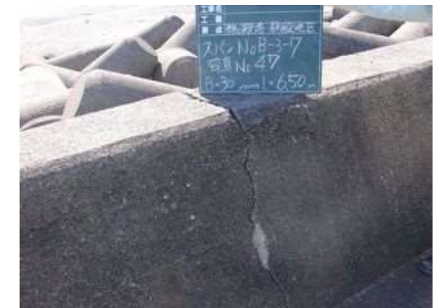
変状：ひび割れ(鶴殿港鶴殿地区)
