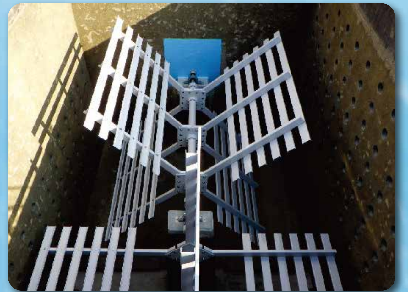
更新した浄水場の緩速攪拌機
