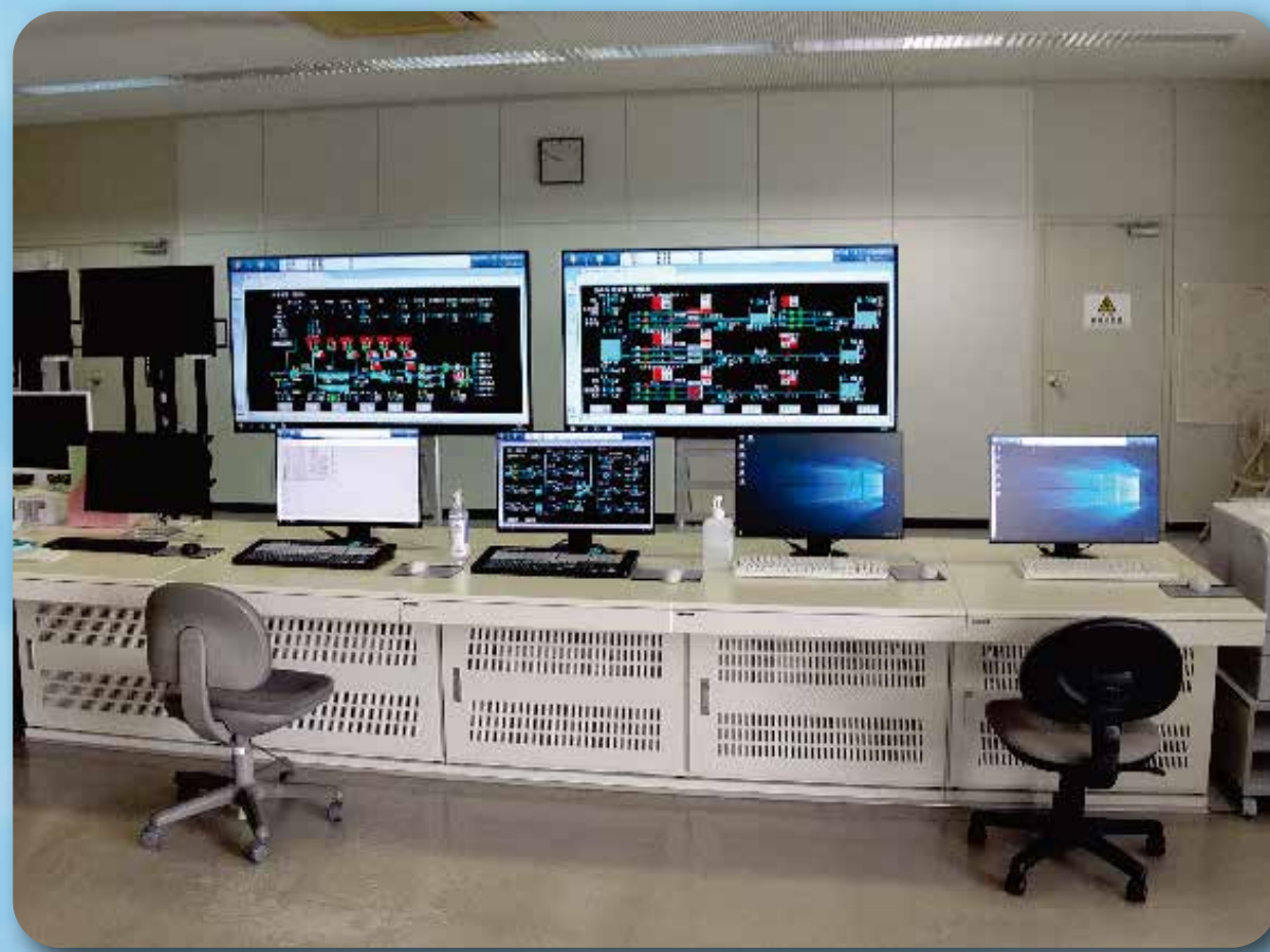
更新した中央監視制御設備
