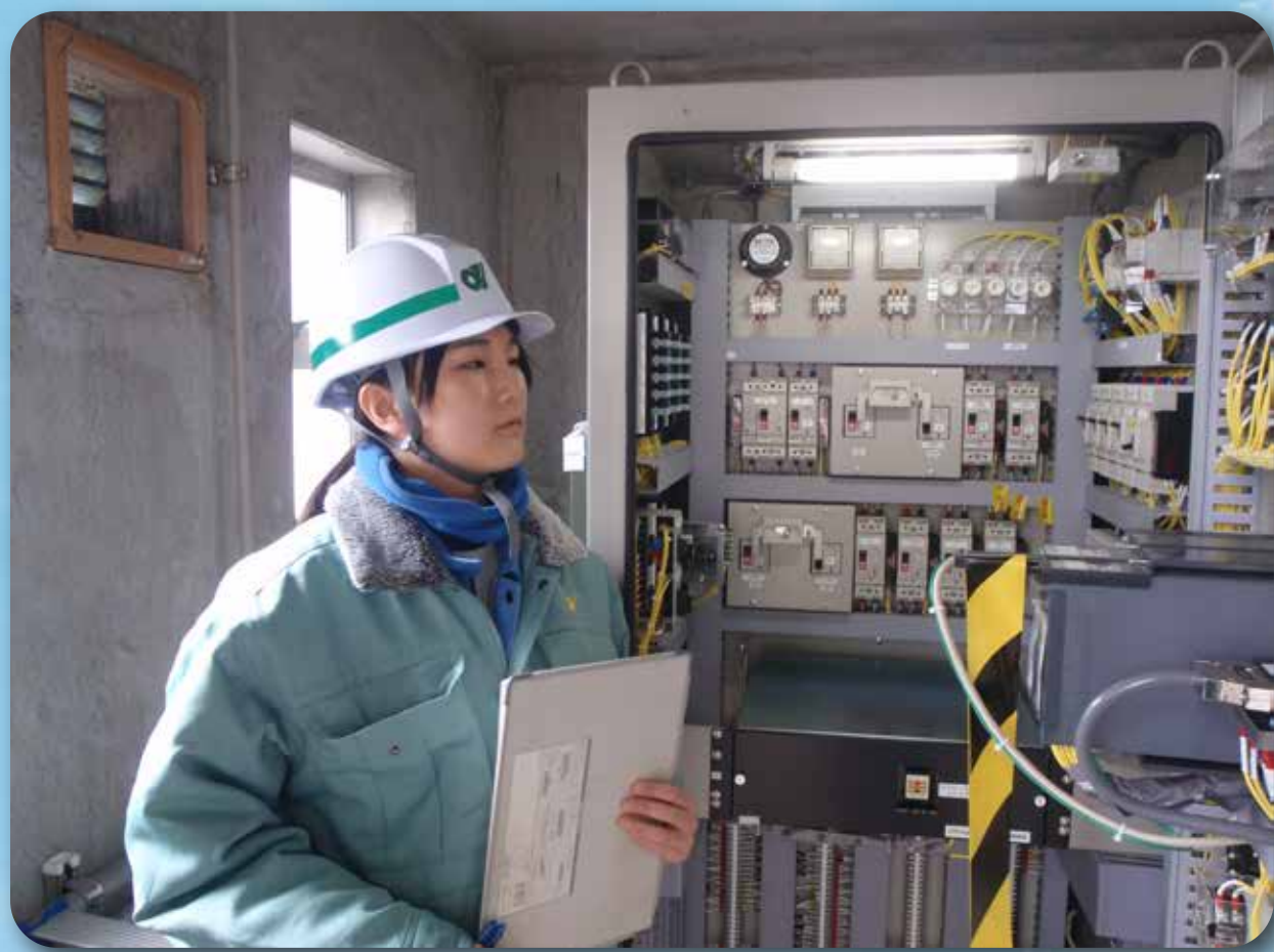
電気設備の点検
