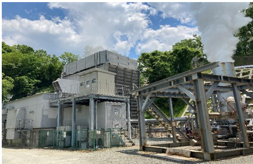
隣地にて稼働中の地熱発電所1号機
