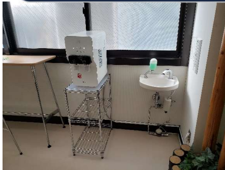
県庁厚生棟地下1階に設置
