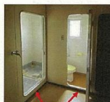
③ 段差残る ※改修前写真、改修後も段差有
