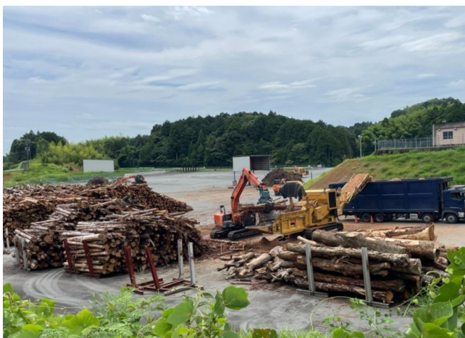
バイオマス燃料チップの製造状況
