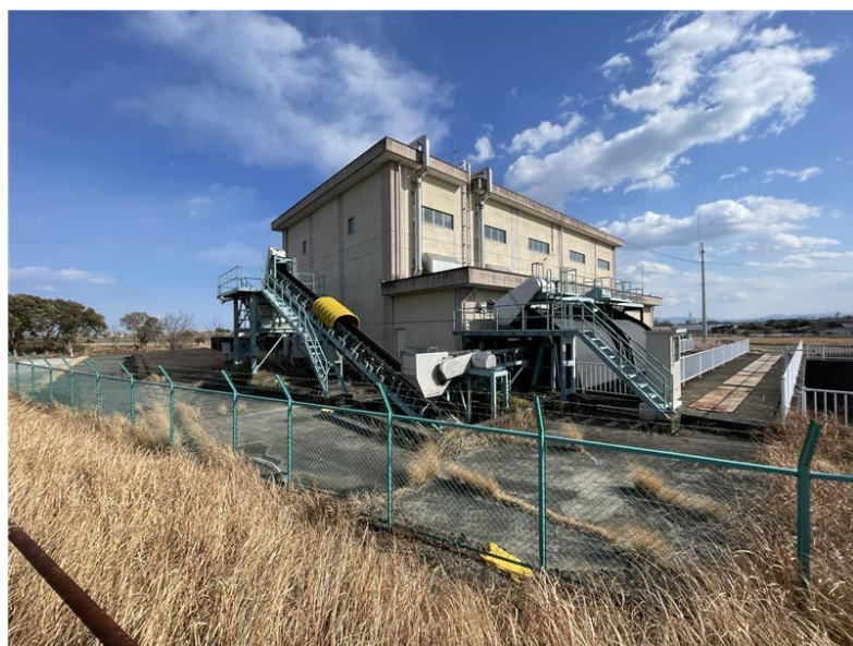
百々川 排水機場
