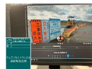
PCで現場状況を確認
