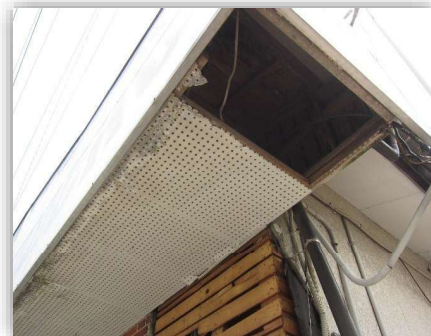
地震で破損した石綿含有成形板（環境省）
