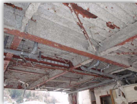
津波で露出した石綿含有吹付け材（環境省）
