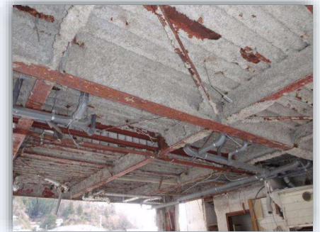
【津波で露出した石綿含有吹付け材(環境省)】 8
