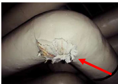
石綿含有断熱材、保温材、 耐火被覆材
